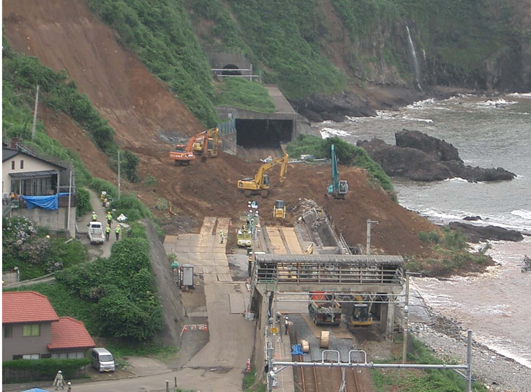
土砂崩れで1カ月間電車が不通(青海川駅)
