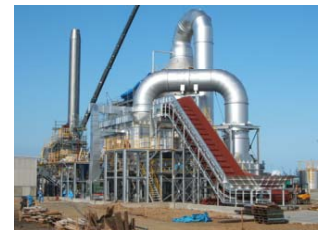
(仙台市設置仮設焼却炉)
