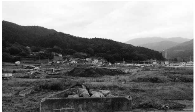
浸水域のかさ上げ工事の様子。こうした浸水域の利活用という地域の課題と、集団移転等の住居の課題は切り離せるものではない（岩手県大船渡市）
